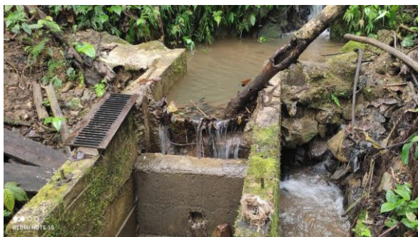
Captación Los Molinos- San Francisco
